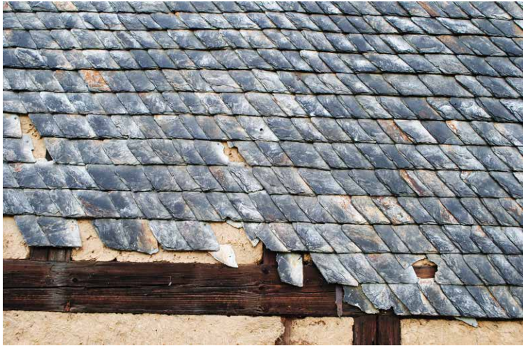
Abb. 12 | Abb. 12 Giebel des Hauses Am Ring 17b in Penna (Zustand 2011) mit direkt auf die Lehmausfachung genagelten Schieferplatten.
