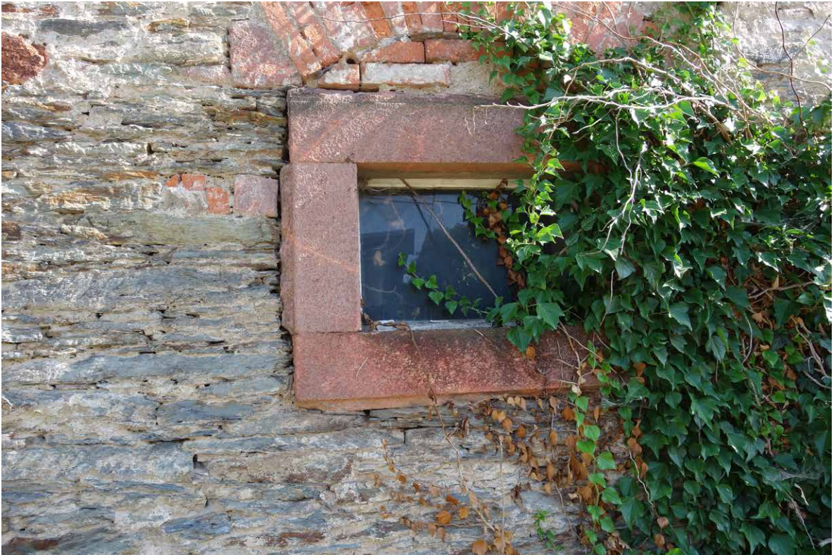
Abb. 18 | Schieferplatten im Bruchsteinmauerwerk an einem Gebäude in Zettlitz (Arnsdorfer Str.), Zustand 2022.
