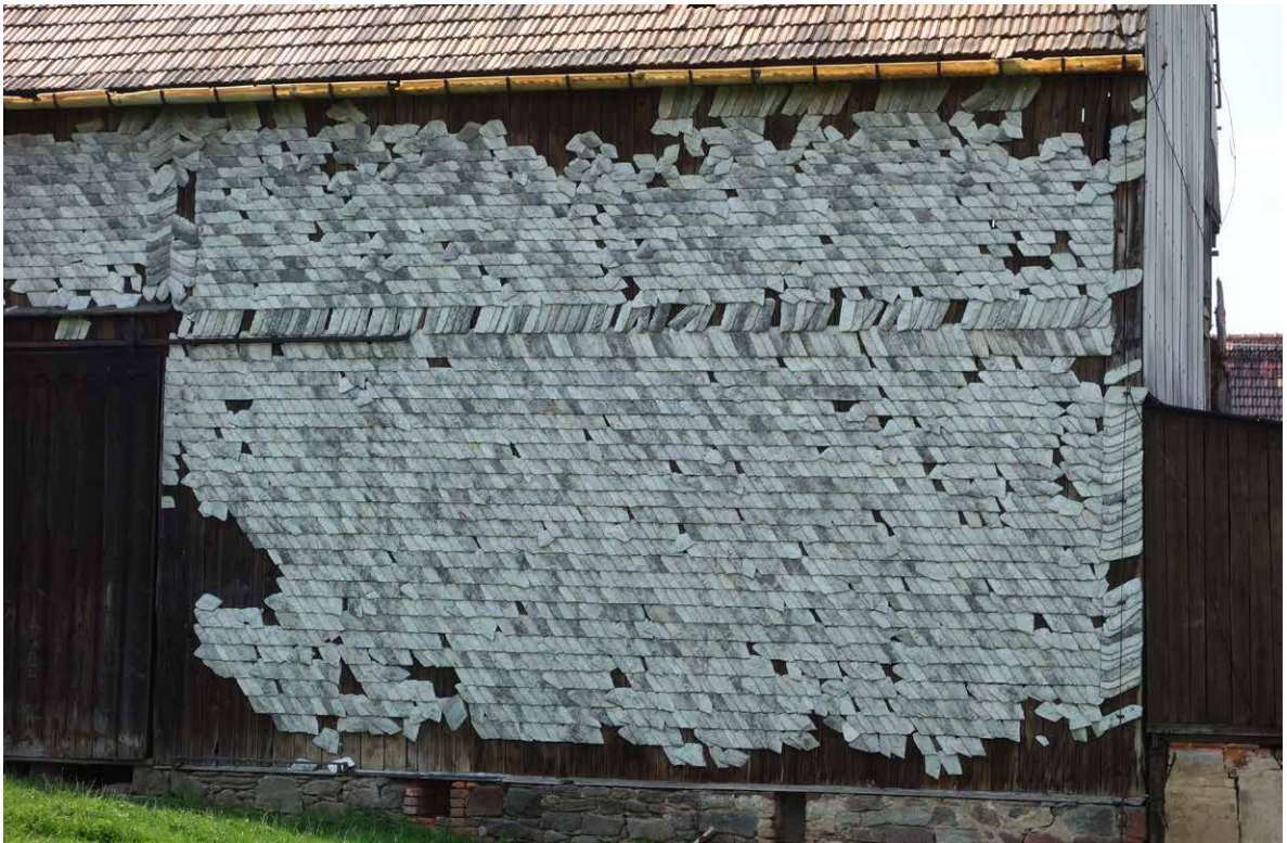
Seitenwand einer Scheune in Rux (Am Teich 4) mit direkt auf die Holzwand genagelter, stark beschädigter Verkleidung aus lokalem Schiefer (Zustand 2022).
