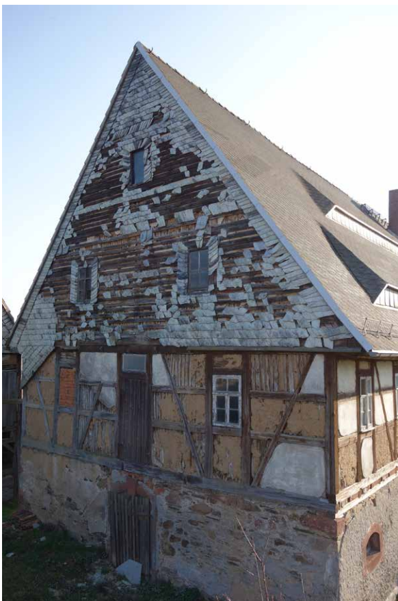
Abb. 11 Stark beschädigte historische Schieferverkleidung an einem Giebel in Ceesewitz (Stöbniger Str. 6, Zustand 2022). An diesem Giebel ist der Aufbau der Verkleidung gut zu erkennen: Auf das Fachwerk wurden Latten genagelt, auf denen wiederum die Schieferplatten befestigt worden sind. Bemerkenswert sind auch das aus Schieferplatten gesetzte Mauerwerk im Sockelgeschoss und die Ausfachung mit teilweise senkrecht gestellten Schieferplatten im Obergeschoss.
