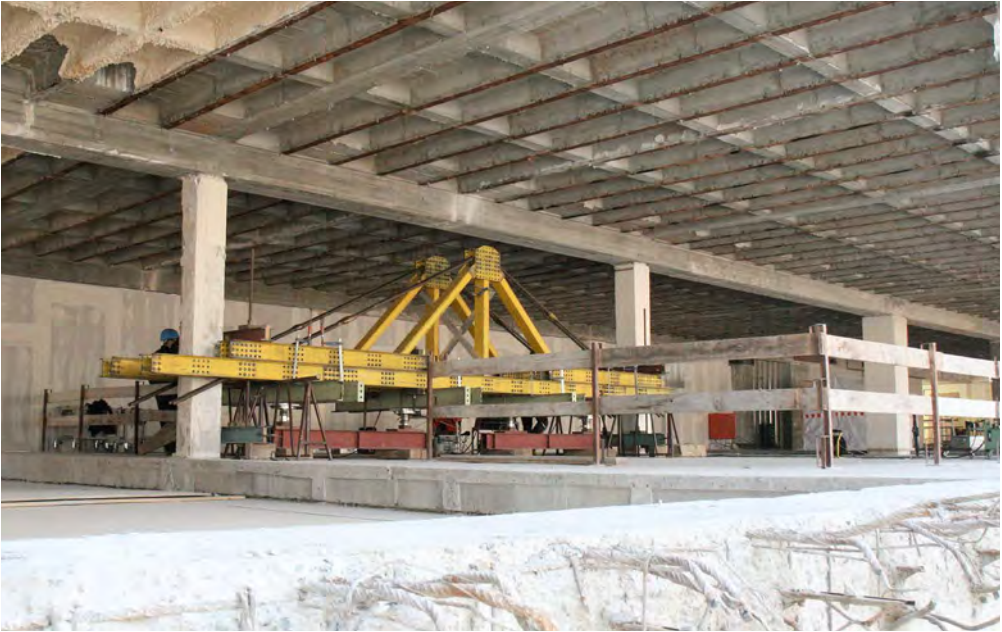
Bild 7: Herausgetrennte Deckenbereiche veränderten die Statik
