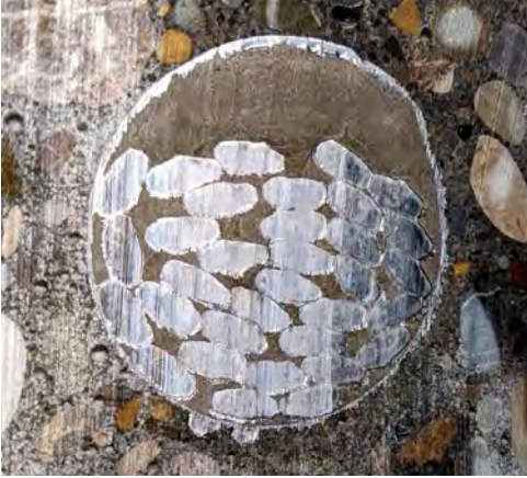
Bild 7: Schnittfläche eines mittels Kernbohrung durchtrennten Spannglieds mit minimalen Einzügen der Spanndrähte (< 1 mm)
