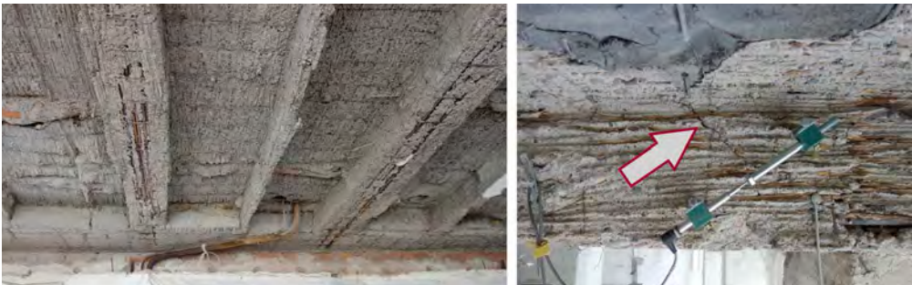
Bild 5: Wayss'sche Rohrzellendecke (links) mit auflagernahem Schubriss (rechts)
